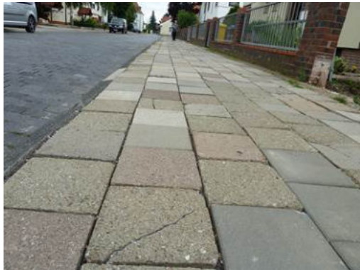
Abbildung 2-3 Sanierungsbedarf in der Feldstraße 7
