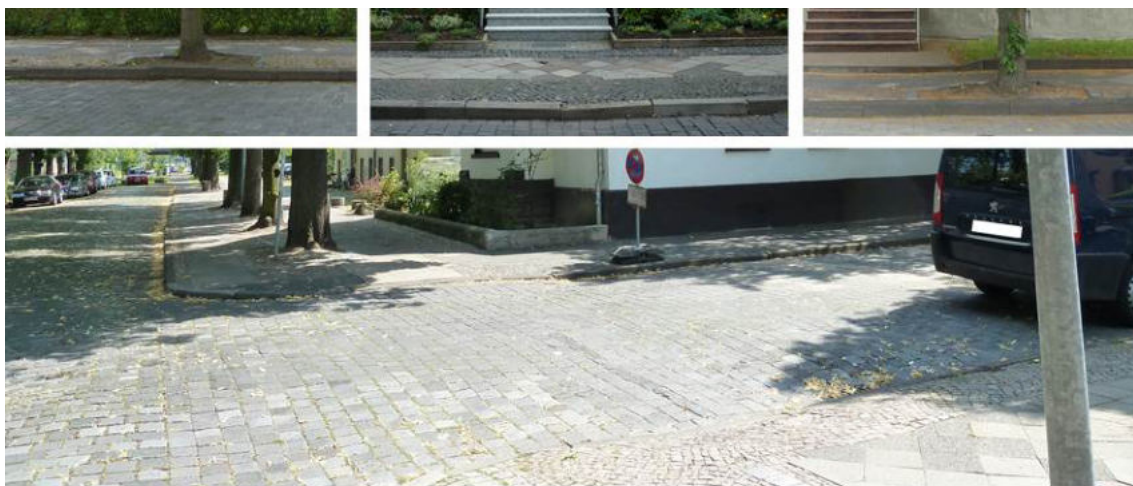
Abbildung 2-4 Sanierungsbedarf in der Pestalozzistraße (unteres Bild Ecke Pestalozzistraße/Kölleddaer Straße) 8
