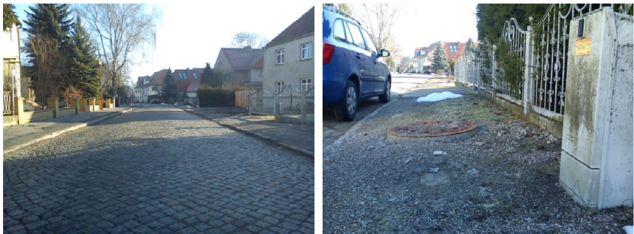
Abb. 25: desolante Situation der Fußwege am Beispiel Mozartstraße; Straßenquerschnitt (links), Fußwegdetail (rechts) (Quelle: DSK)
