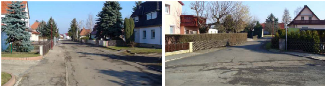
Abb. 20: Beispielhafte Auswahl schadhafter und sanierungsbedürftiger Verkehrsanlagen in der Mozartstraße (links) sowie der Sebastian-Bach-Straße (rechts) (Quelle: Stadt Sömmerda/IB Pöppich&Albrecht)
